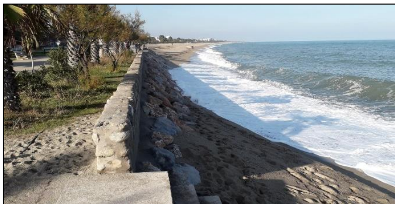
Illustration 82 – Recul du trait de côte et érosion de la plage après la tempête du 28 nov 2020 au droit de la digue de haut de plage au sud de la promenade de la mer, plage des pins (source DDTM 66 – 30/11/2020)
